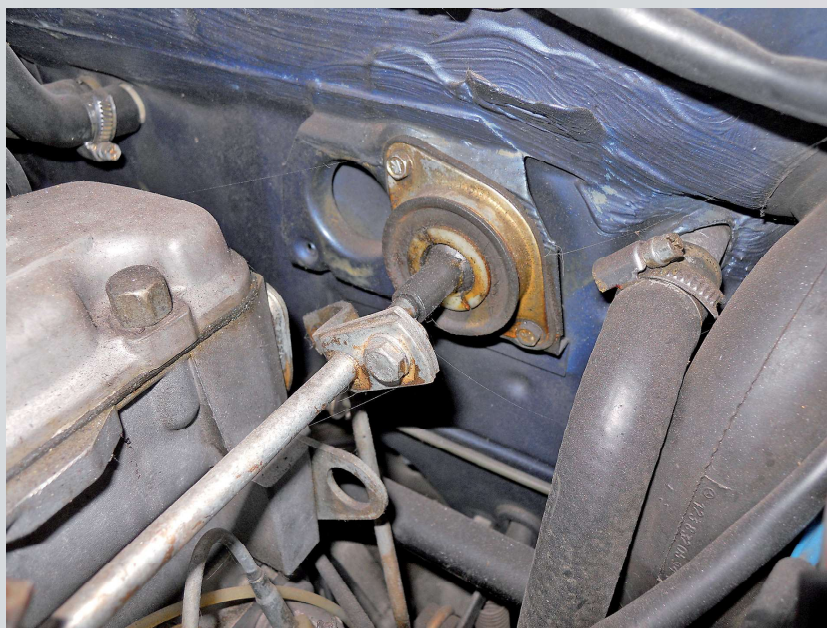
Bild 5: Halter des Gasgestänges an der Stirnwand, zweite Ausführung für M110. Man erkennt, dass ab Einführung der M102 die Rohkarosserie aller 123er geändert wurde.
